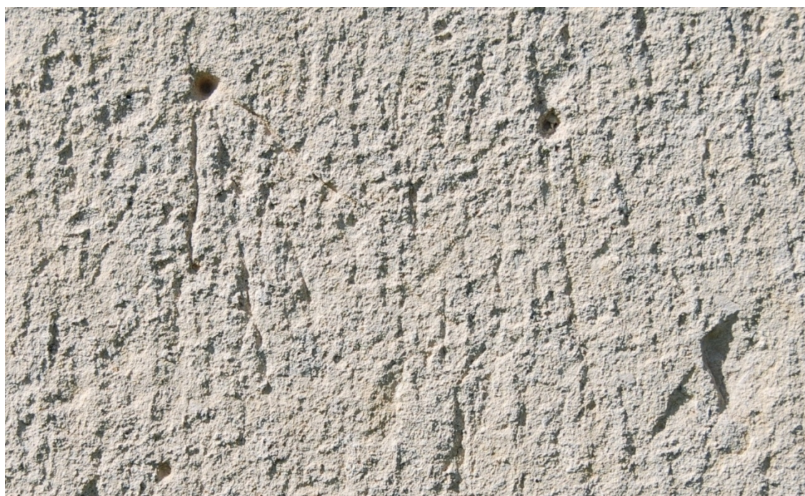
Relojes 2 y 3. Radiales en la cara del sillar. Muy deteriorados
