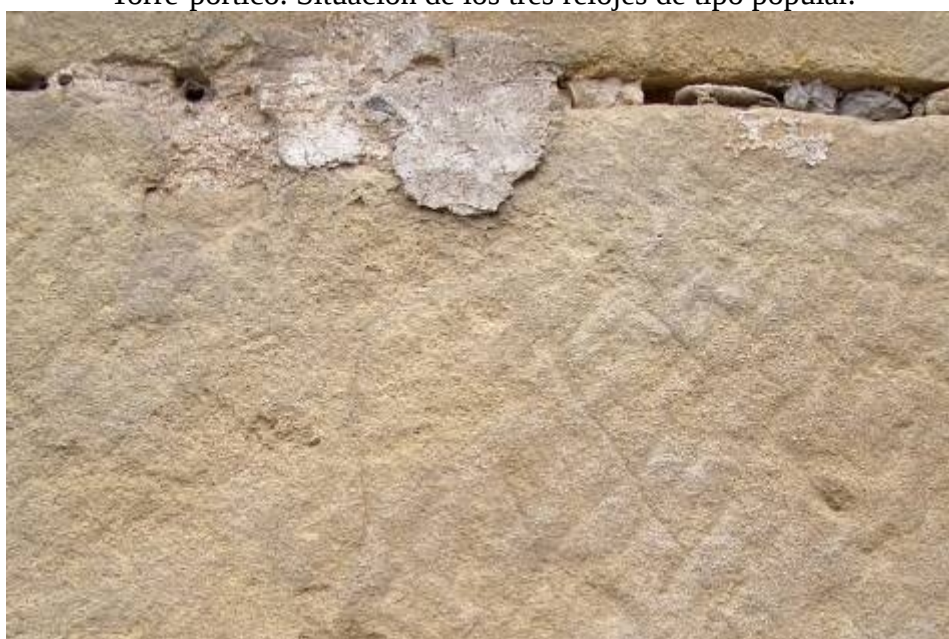
Reloj 3. Radial en junta de sillar. Muy deteriorado.
