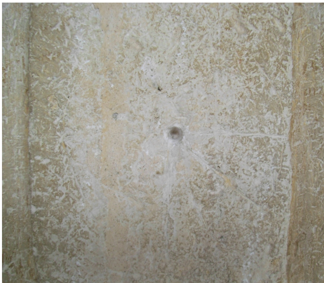
Reloj circular muy deteriorado.
