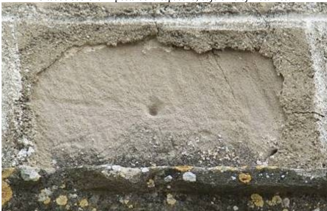
Radial en la cara del sillar. Muy deteriorado.
