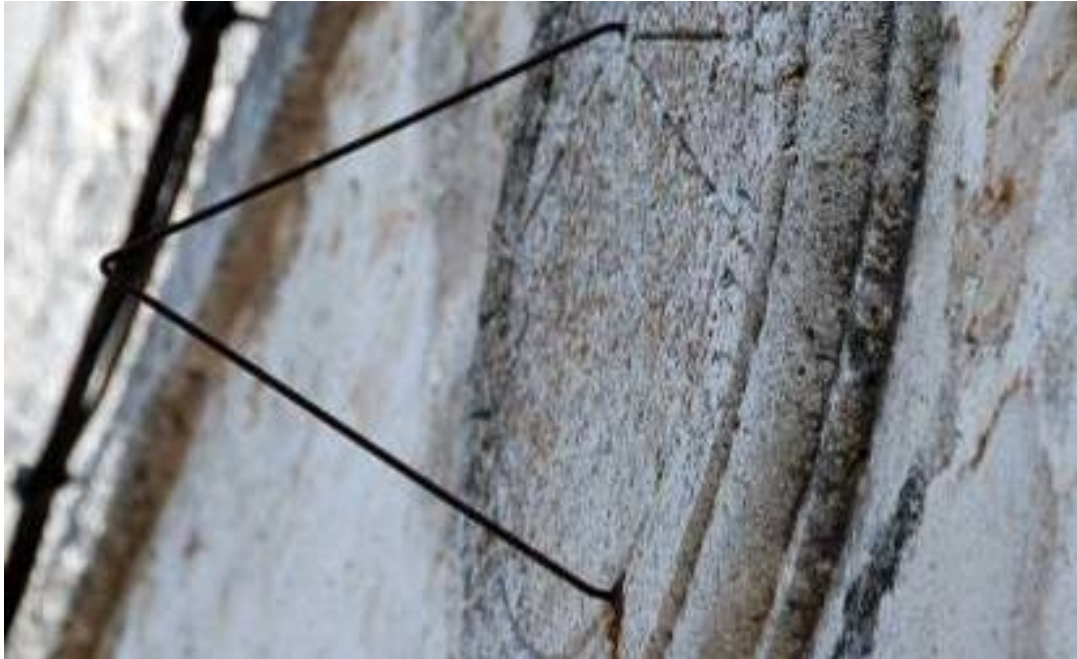
El tramo de apoyo de la varilla repuesta no es perpendicular al plano del reloj.
