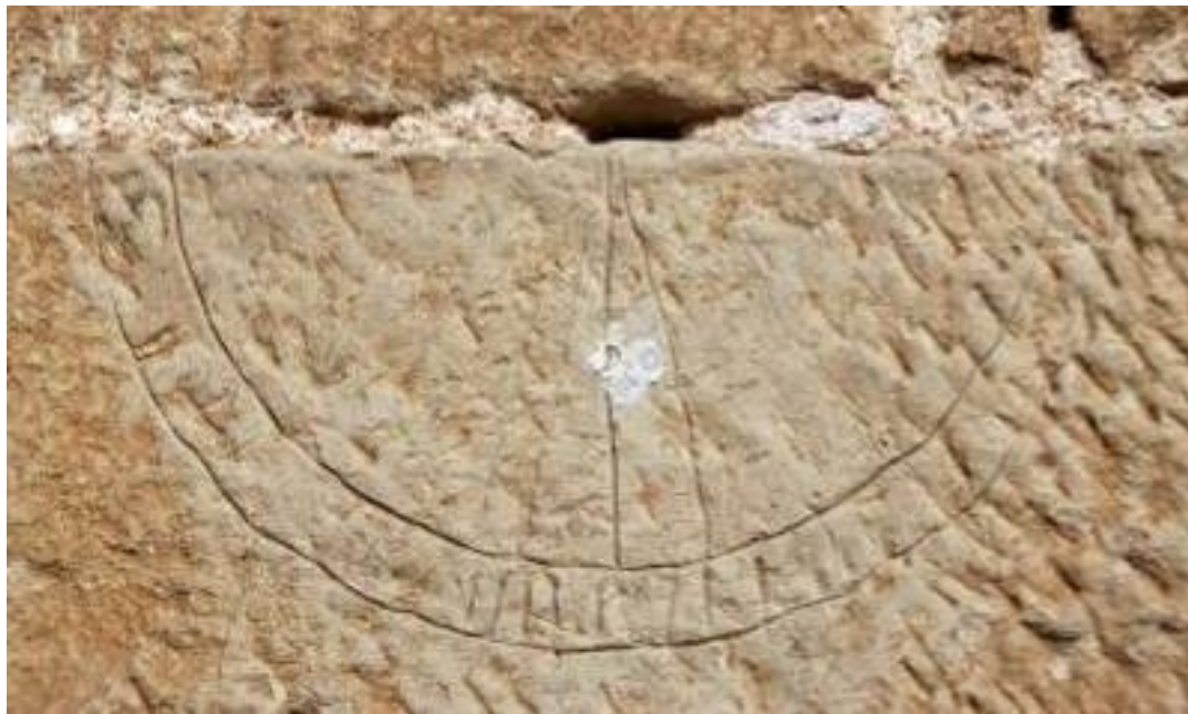
Reloj 4. Semicircular en junta de sillar. Muy deteriorado D=34 cm.
