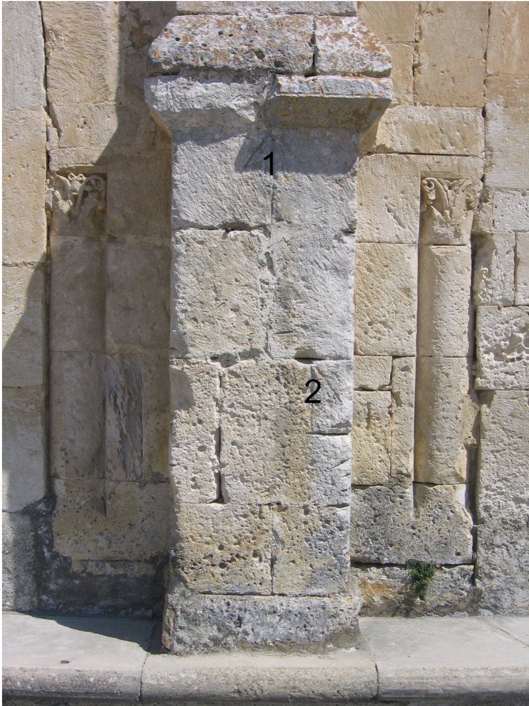
Basamento de la columna derecha del arco central. Los dos relojes canónicos.
