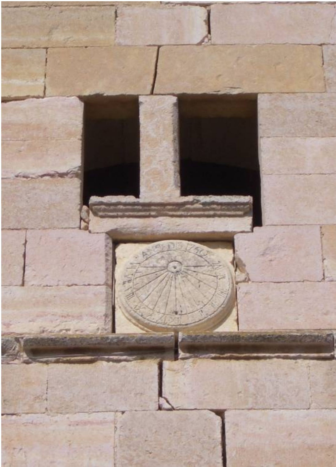
Situación del reloj de sol en el muro. Grieta.
