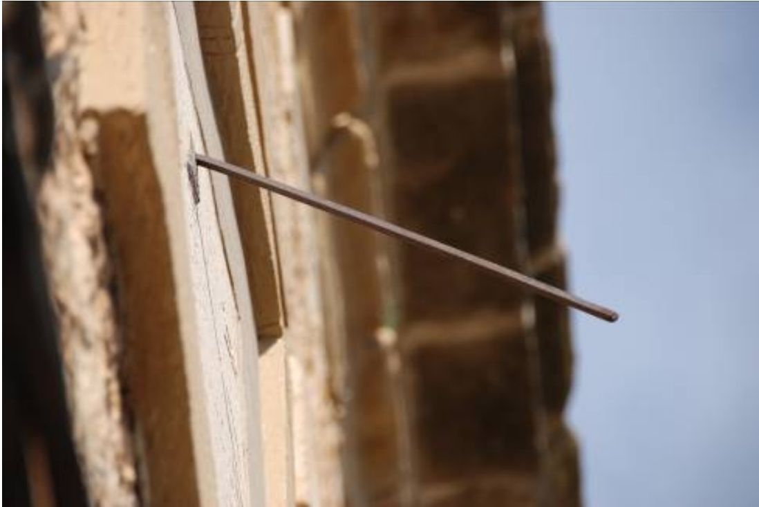
Detalle de la varilla de perfil cuadrado repuesta.
