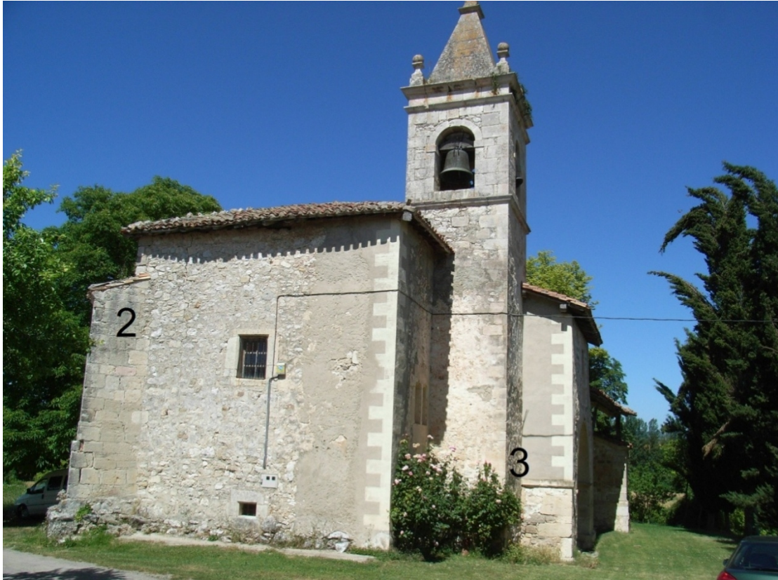
Relojes 2 y 3. Contrafuerte de la esquina NO. Primer cuerpo de la torre.
