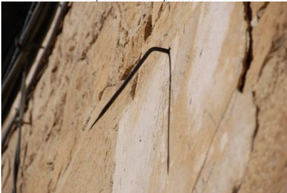
Varilla mal orientada.
