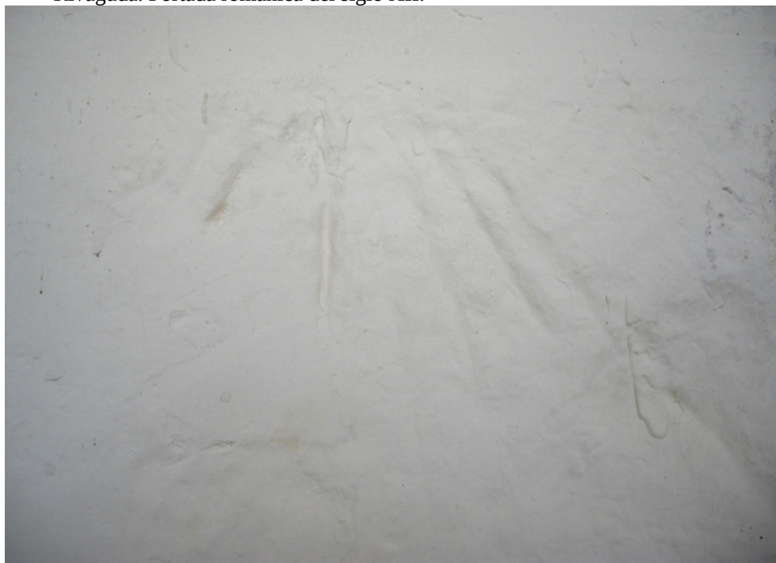
Radial en junta de sillar oculto bajo el encalado.
