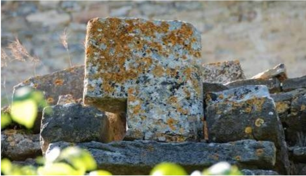
Entalladura, esquina derecha a bisel, calzado con ripios, mal orientado..
