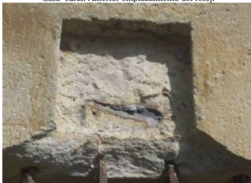
Detalle. El hueco dejado por la placa.
