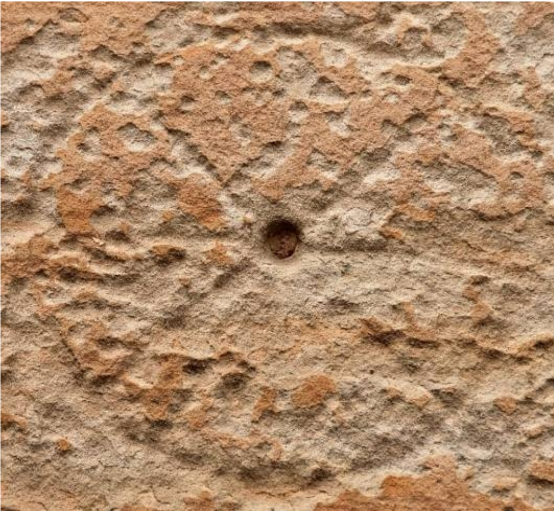
Detalle de la erosión. Extremo de una varilla de madera ocluyendo el orificio.
