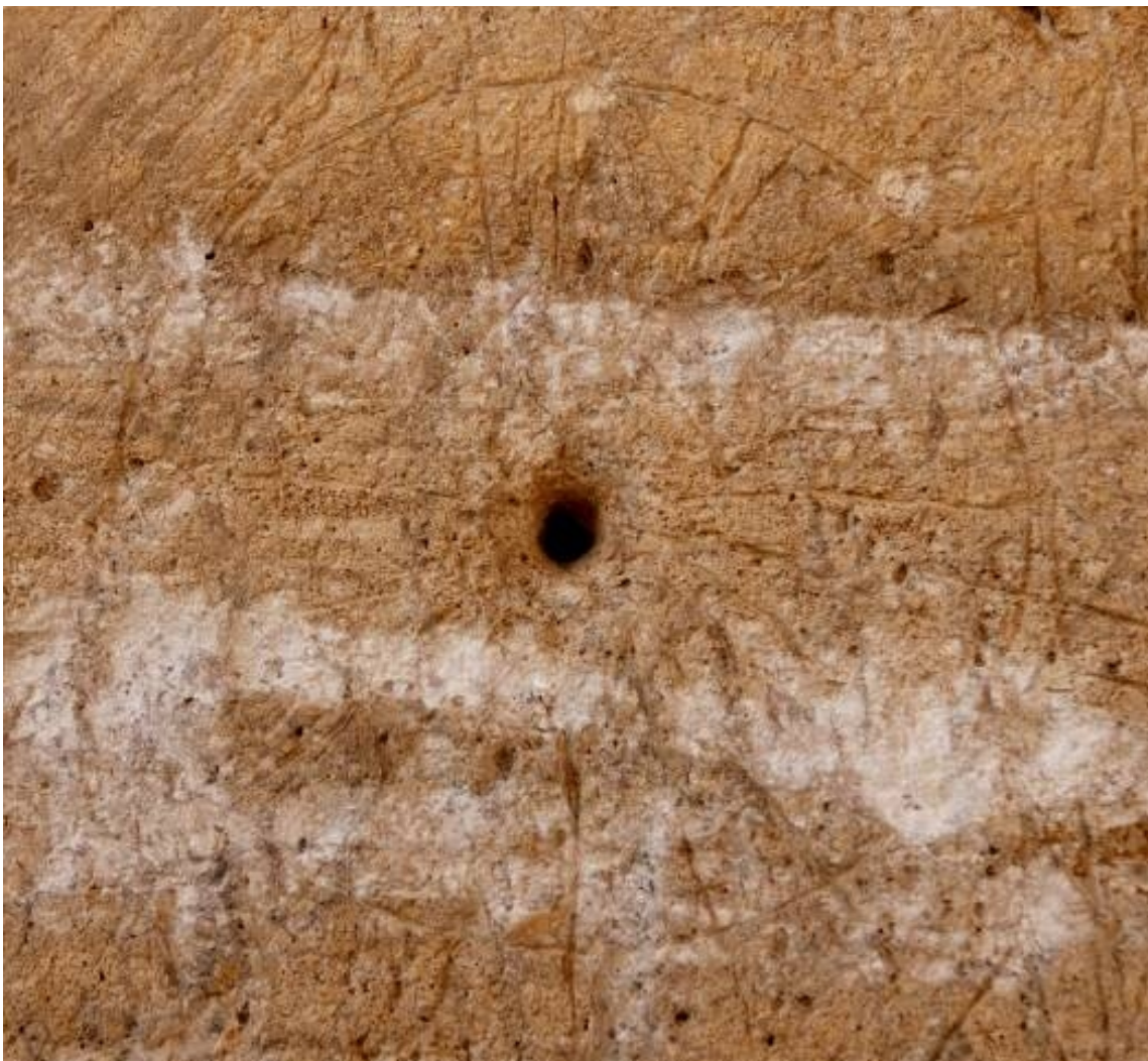
Circular en la cara del sillar. Deteriorado y manipulado.
