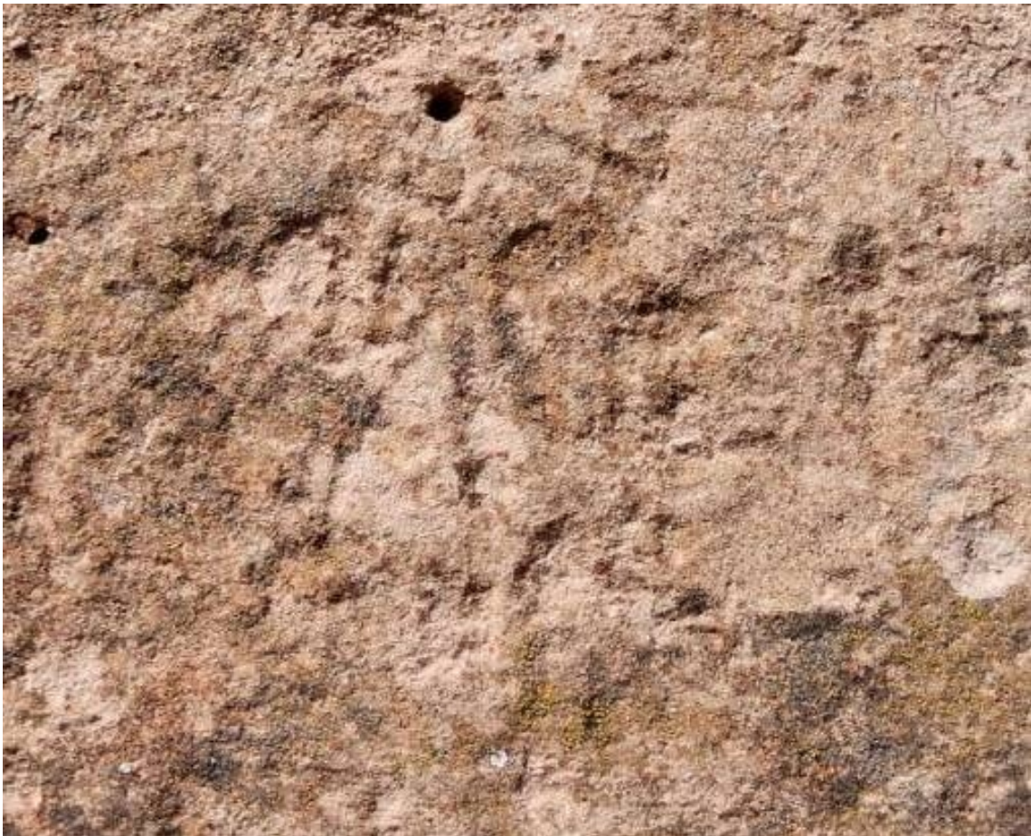
Reloj 2. Radial en la cara del sillar. Muy deteriorado.
