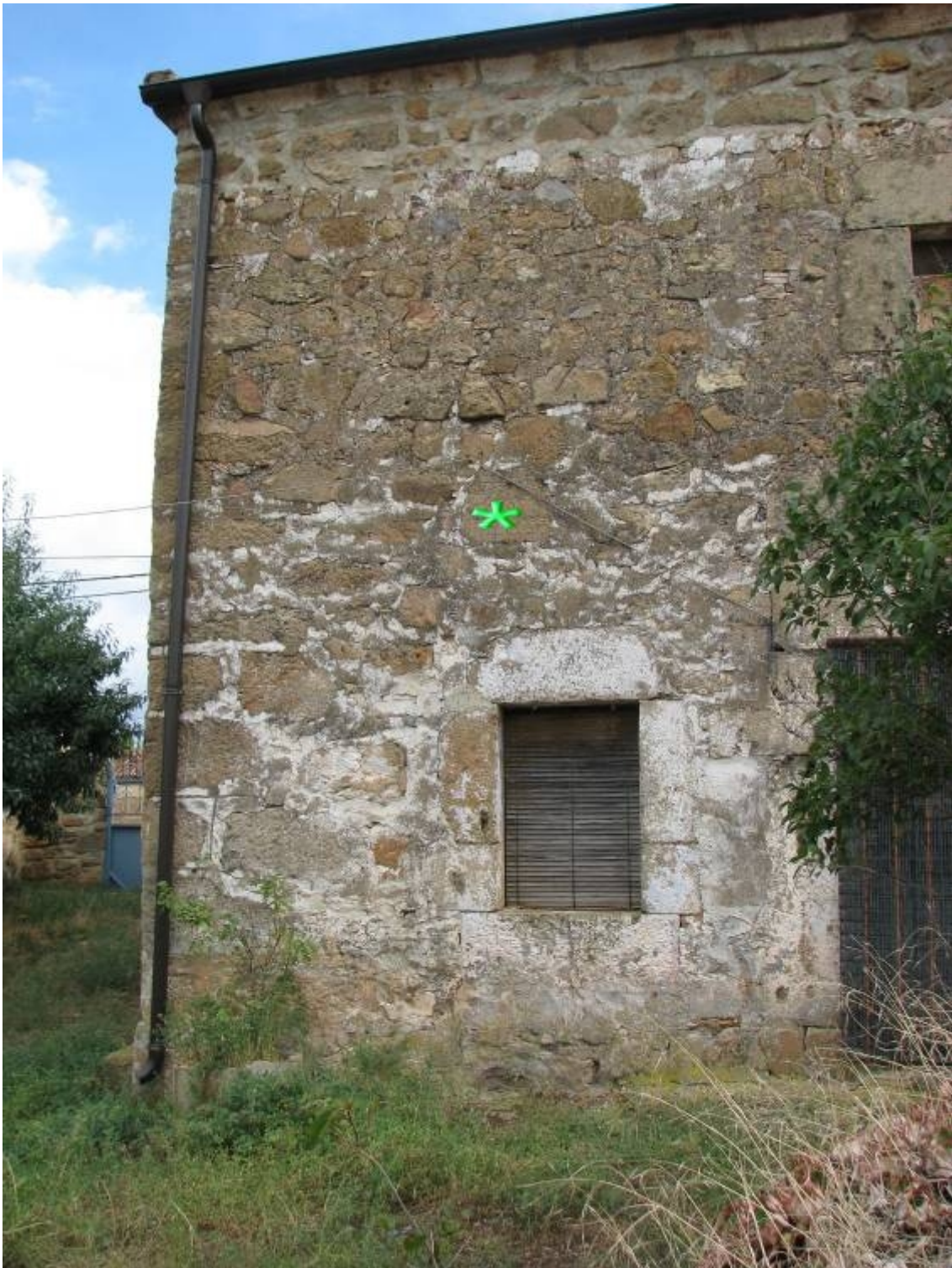
Empotrado en el muro de mampostería de la fachada de casa Lucio.
