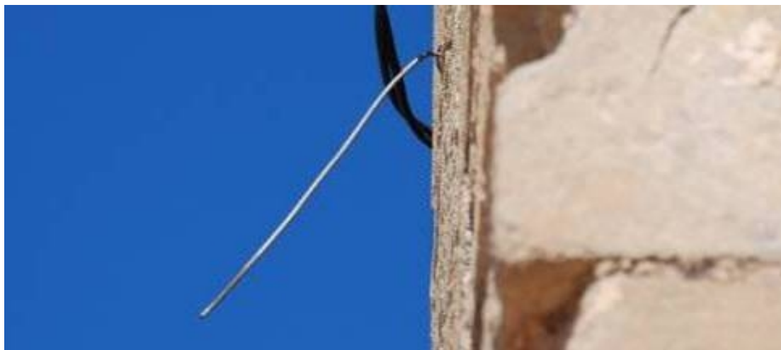
Varilla repuesta. No coincide con el polo y está mal orientada.
