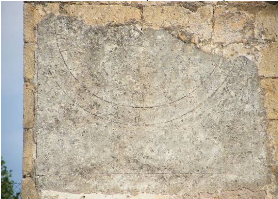
Se ha desprendido la zona superior del enlucido. Orificio en la junta vertical.
