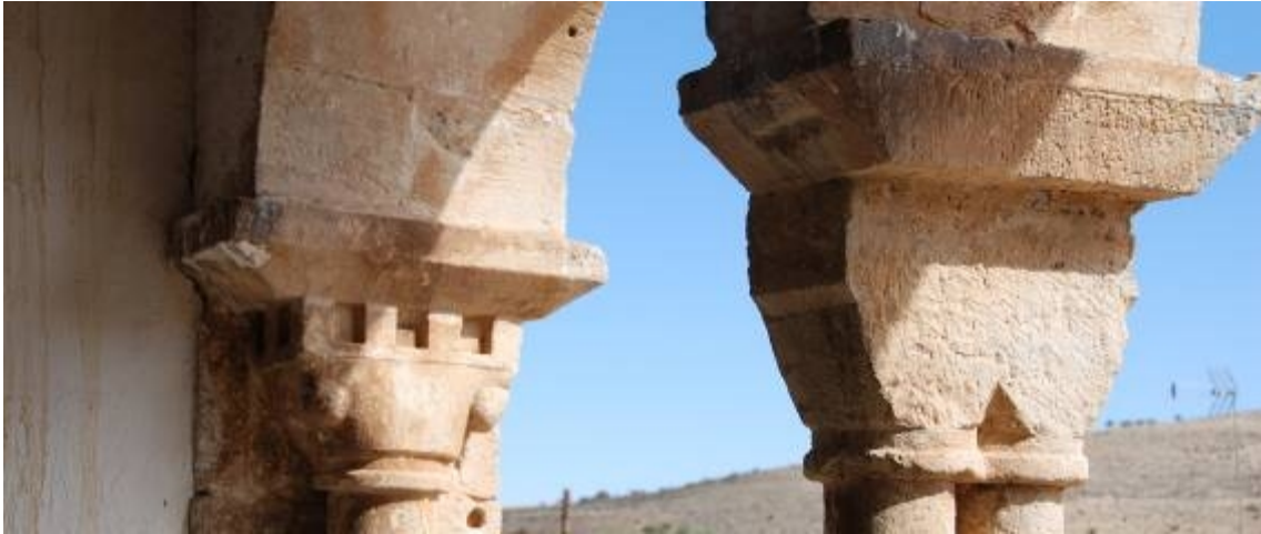
Los capitales de las dobles columnas centrales están cortados.
