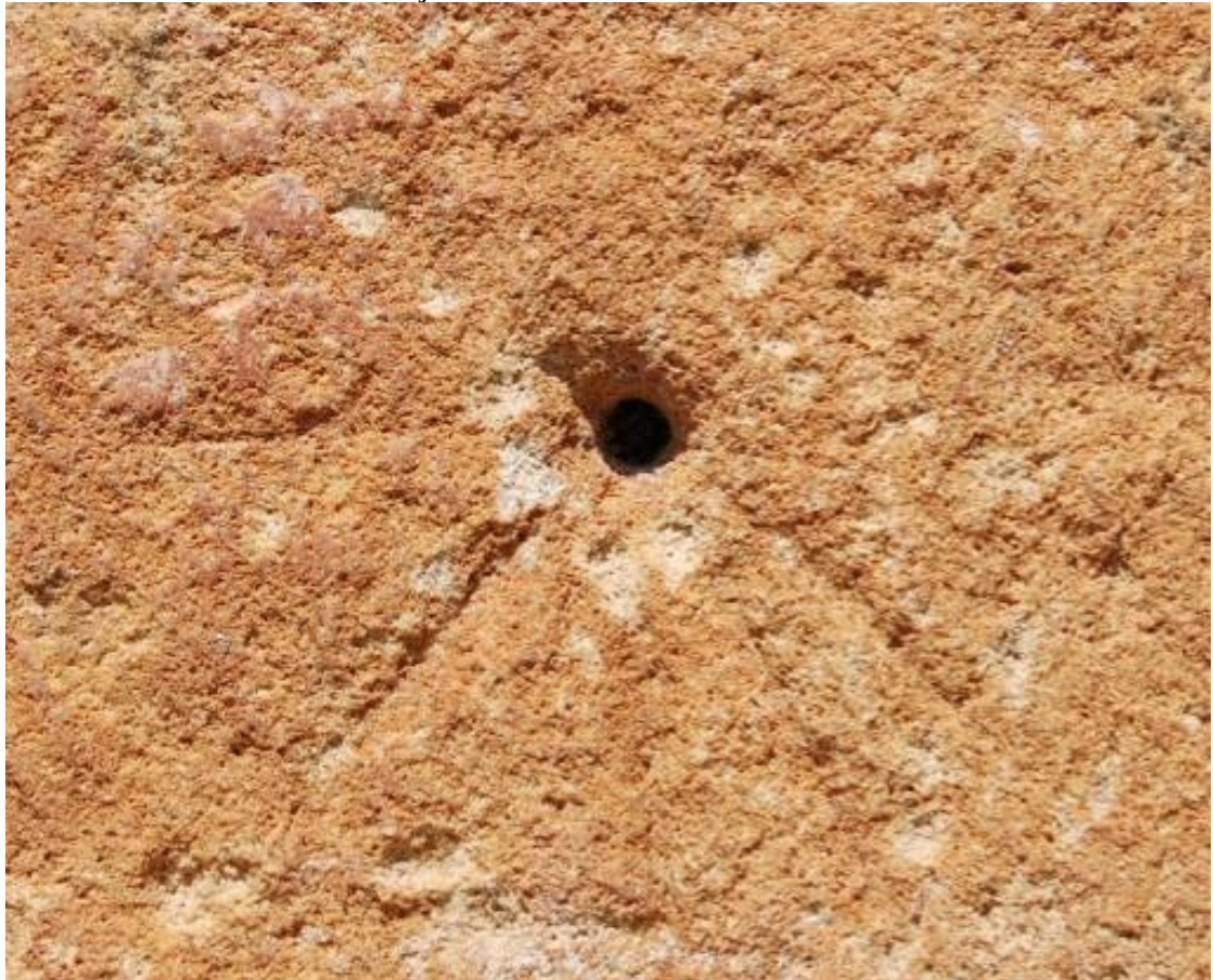
Reloj 3. Circular en la cara del sillar. Muy deteriorado. D=12 cm.
