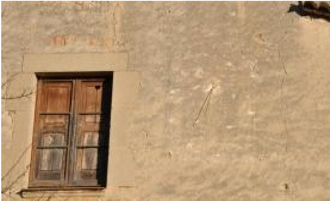
Rectangular. VDL. Varilla de un apoyo. Muy deteriorado.
