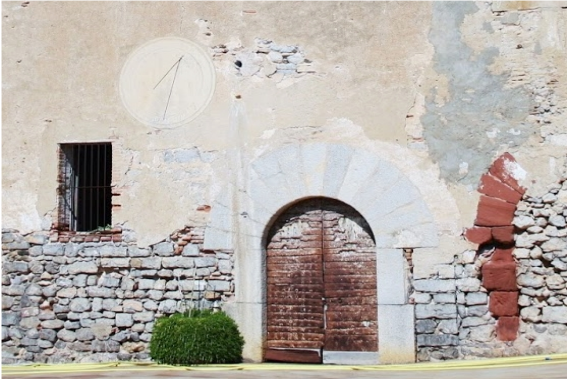
Circular. Polo desplazado hacia la derecha. VDL. Varilla de un apoyo.
