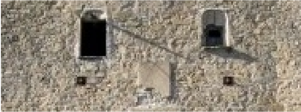
Rectangular. Desprendimiento en la parte inferior. Varilla de un apoyo.
