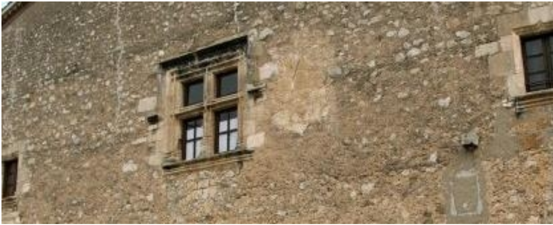
Conserva la varilla y restos del enlucido.
