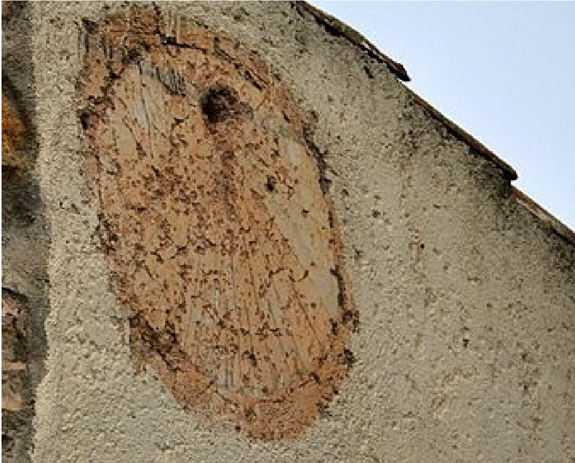
Circular. VDL. Varilla de un apoyo desaparecida.
