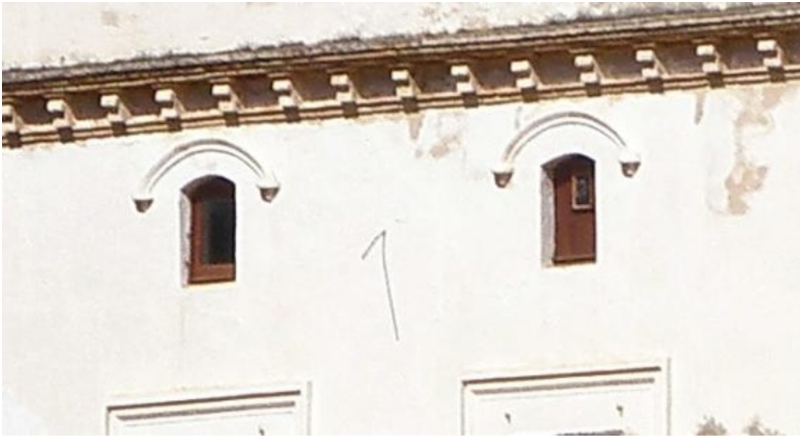
Solamente queda la varilla.
