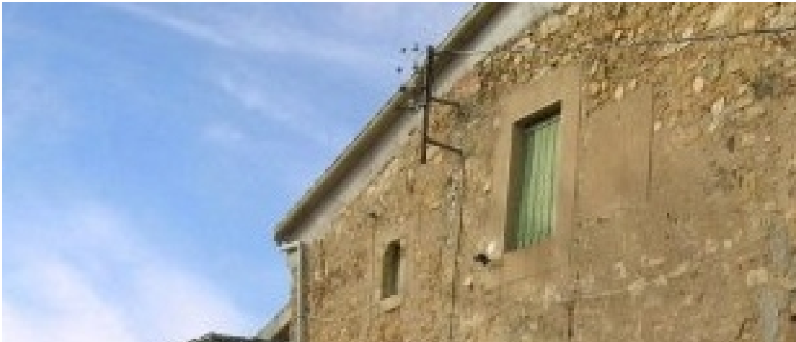
Superficie rectangular enlucida a la derecha de la ventana central. Ha perdido la varilla.
