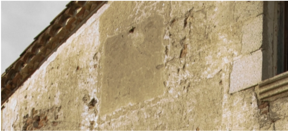
Superficie rectangular enlucida a la izquierda de la ventana central del primer piso. Rastros de líneas horaras. Orificio de la varilla en el centro del lado superior.
