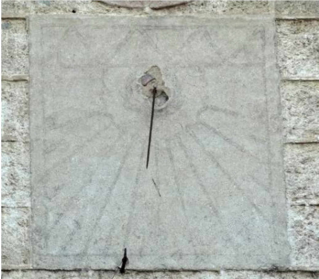
Ha perdido la pintura.
