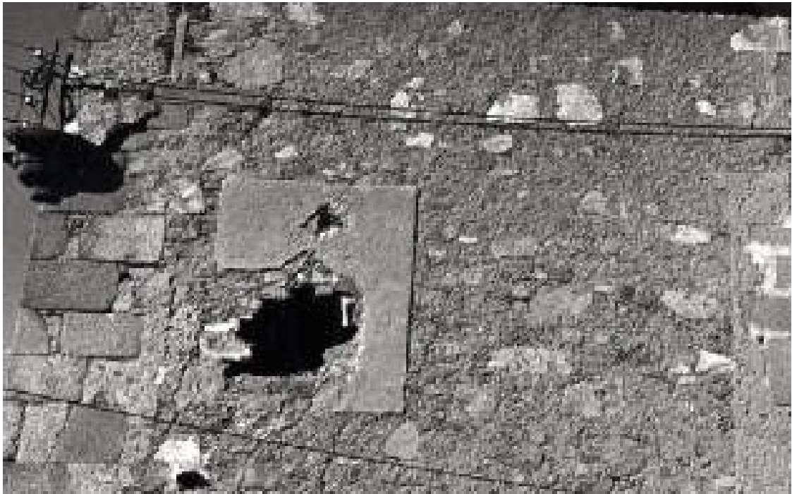
Rectangular. Muy deteriorado. Varilla de un apoyo desaparecida.
