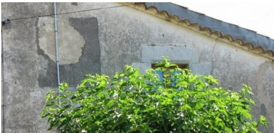
Desprendimiento del enlucido. Se distinguen algunas líneas horarias.
