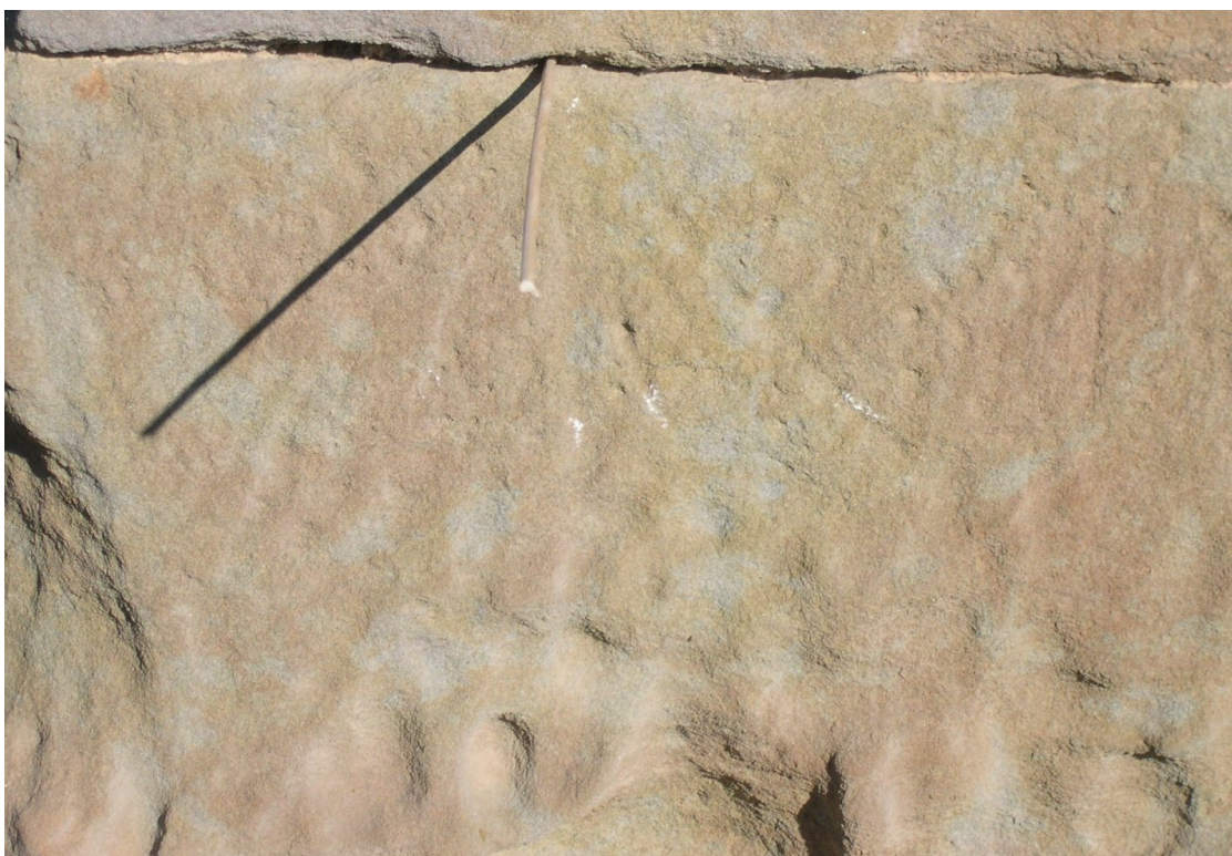
Reloj 10. Radial en junta de sillar. Deteriorado.
