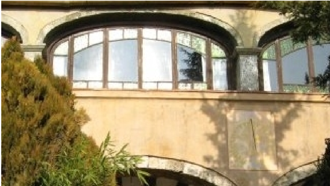
Circular en el interior de un rectángulo con las dos esquinas superiores recortadas a bisel. Varilla de un apoyo mal orientada.
