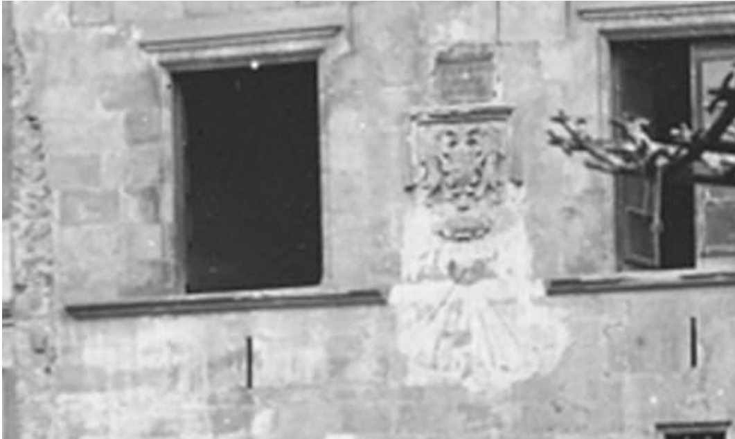
Superficie irregular en calada en el muro de sillares. VDL. Varilla de un apoyo.
