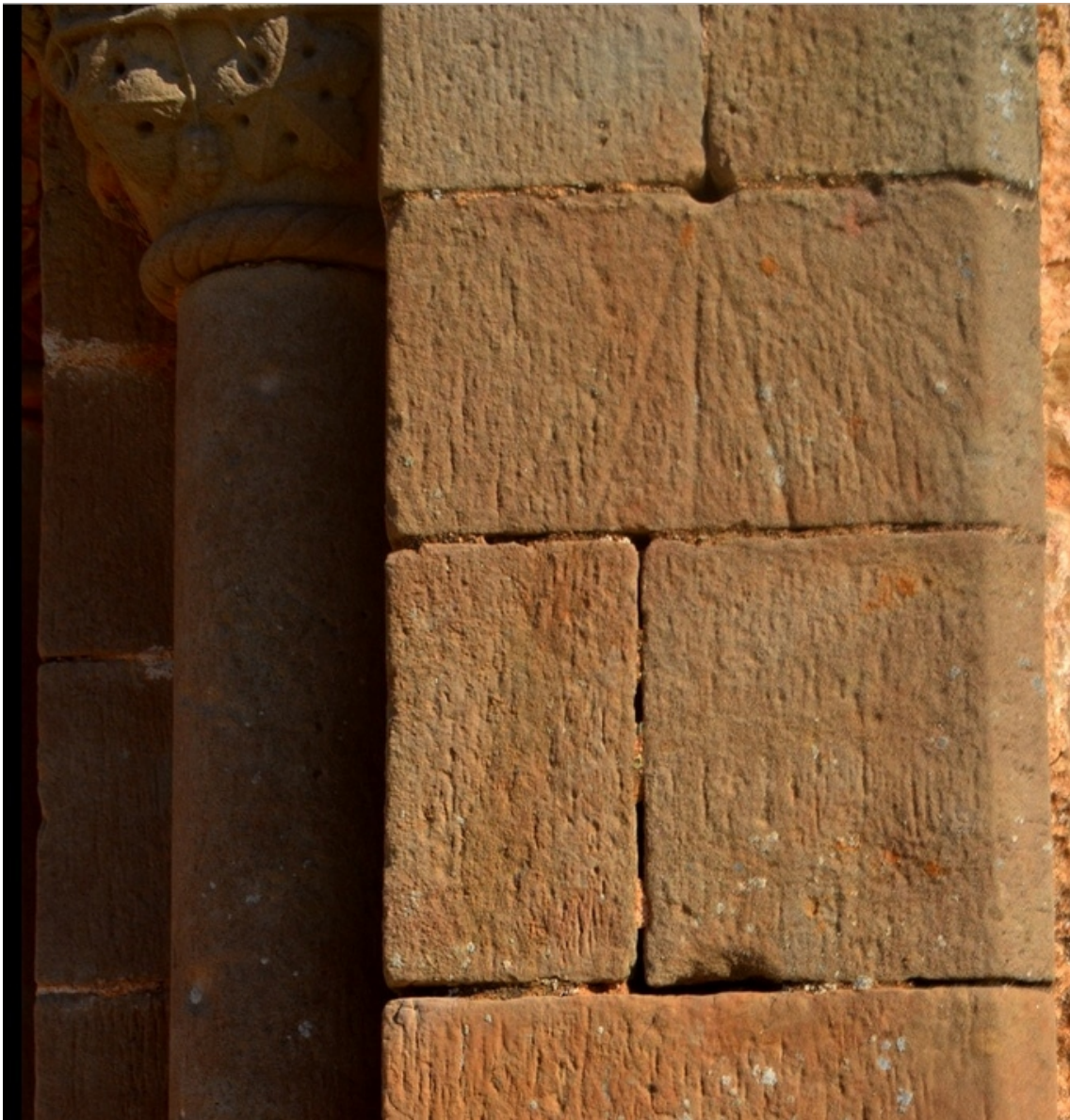
Radial en junta de tres sillares. Deteriorado.
