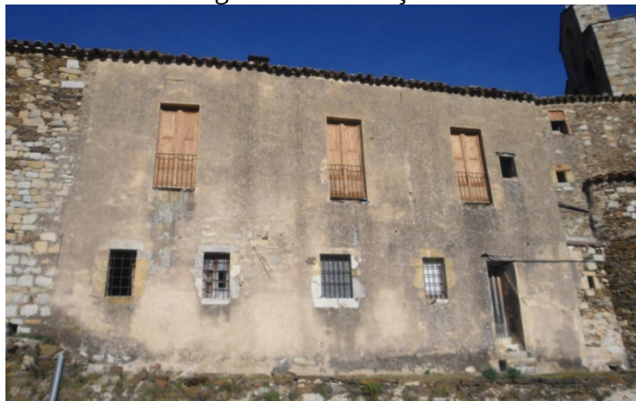
La Rectoria del Coll. Osor. La Selva. Varilla entre las dos ventanas centrales de la planta baja.
