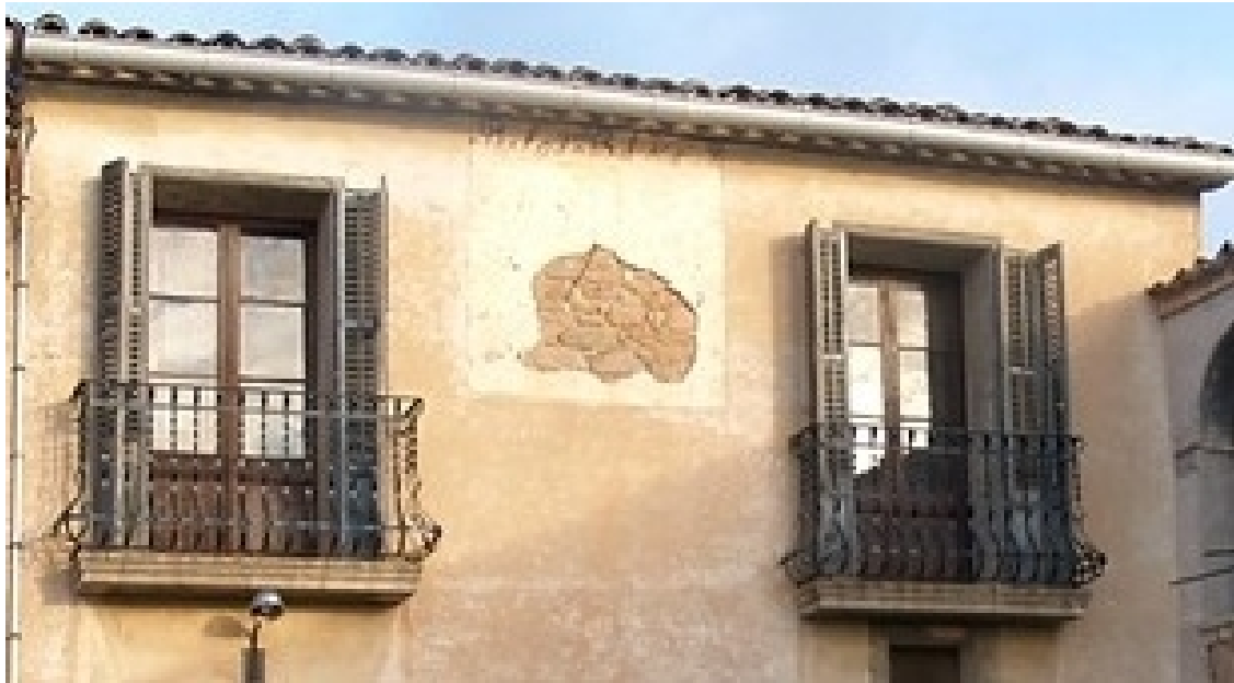
Fachada principal. Cuadrado. Desprendimiento del enlucido. Varilla de un apoyo en el centro. Inscripción en la parte superior.
