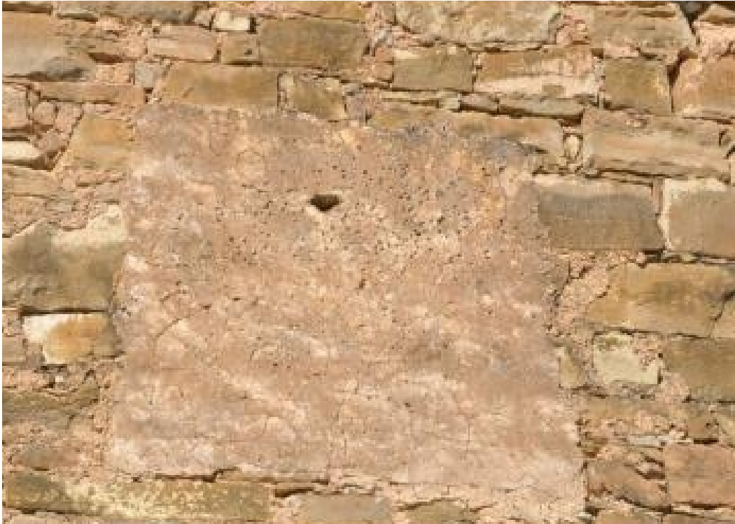
Queda una superficie rectangular enlucida de bordes irregulares y el orificio de la varilla.
