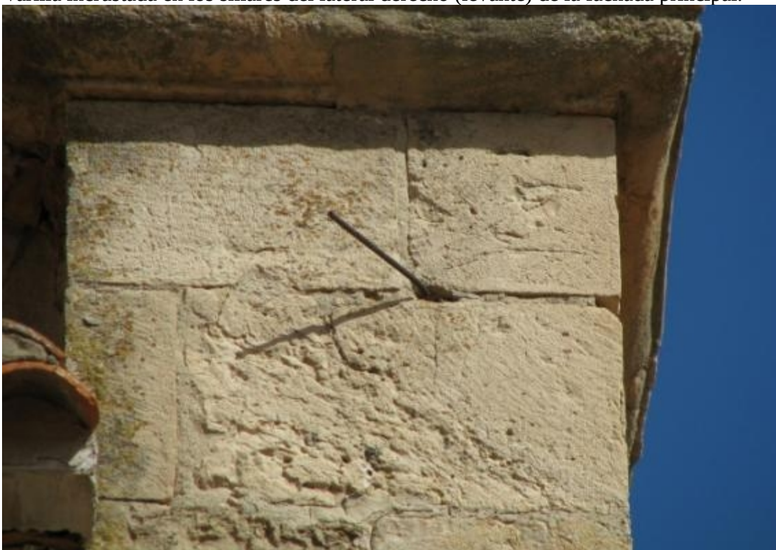
Varilla incrustada en los sillares del lateral izquierdo (poniente) de la fachada principal.
