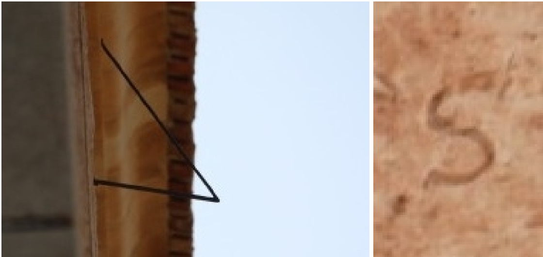
Varilla acodada desprendida del polo.
