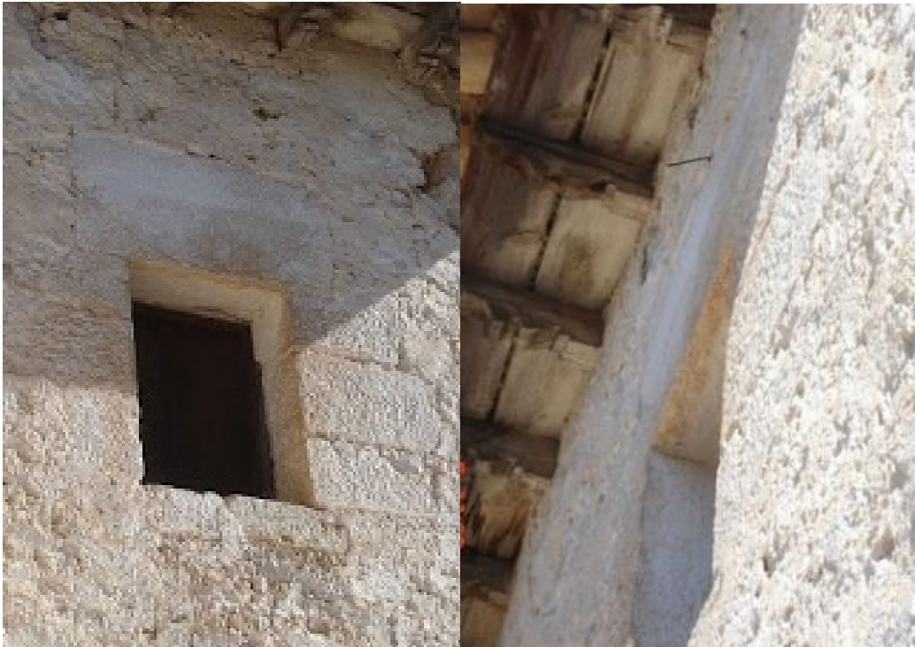
Conserva la varilla de un apoyo colocada en la junta.
