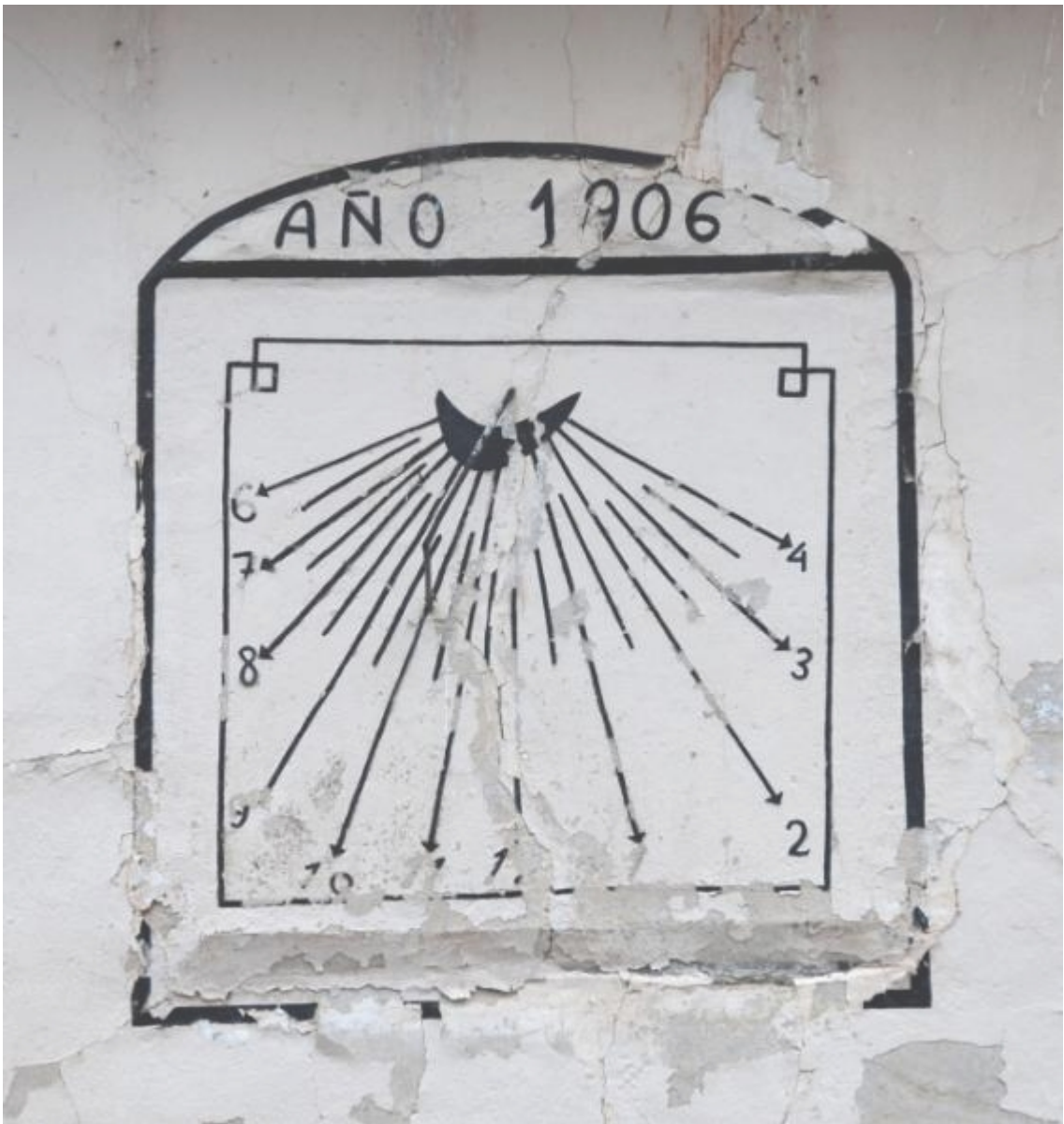
En tres o cuatro años la pintura ha sufrido un deterioro considerable. 18/09/2014.
