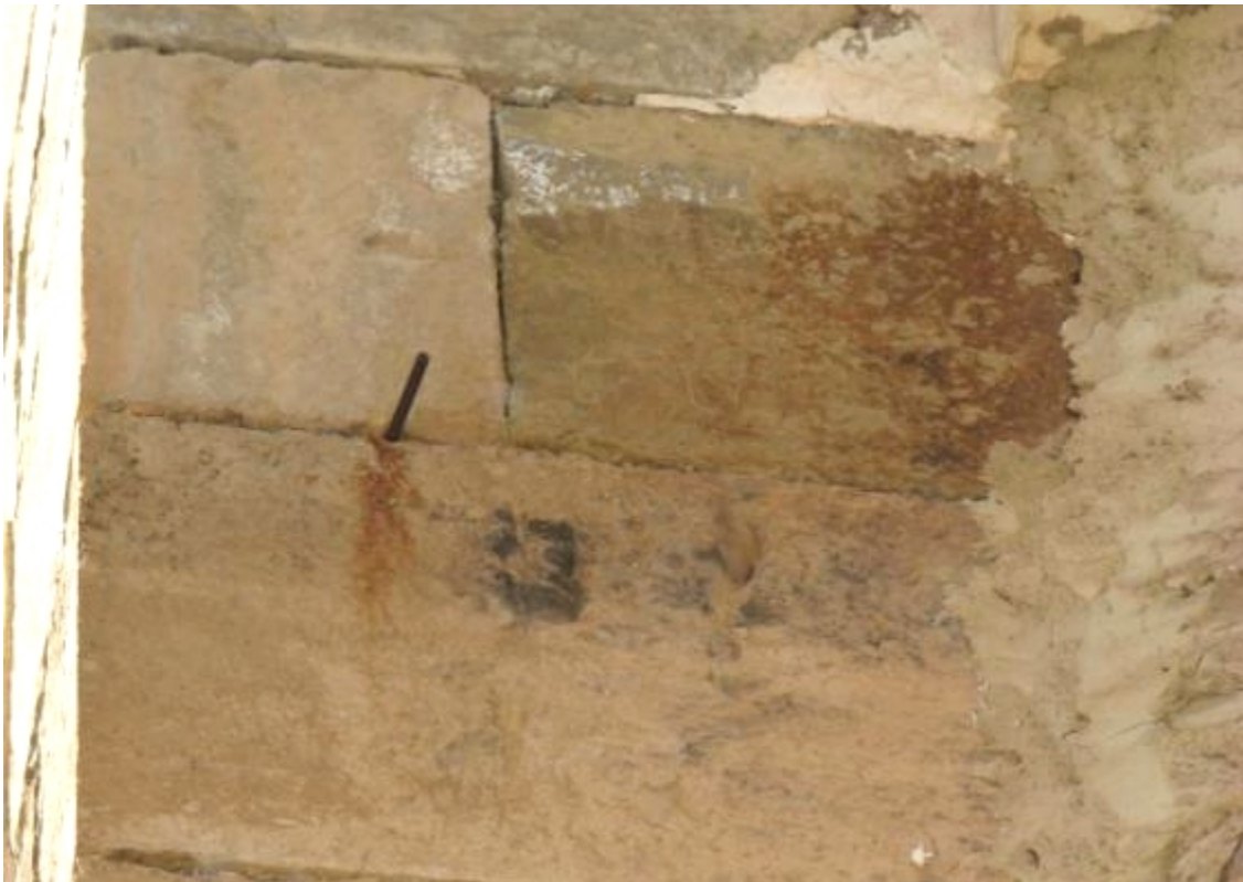
Varilla incrustada en los sillares del lateral derecho (levante) de la fachada principal.
