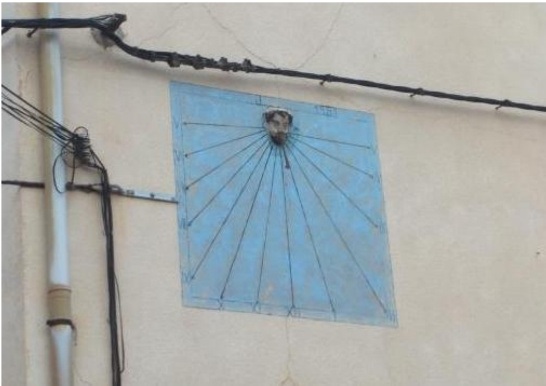
Estado del reloj de sol antes del arreglo de la fachada.
