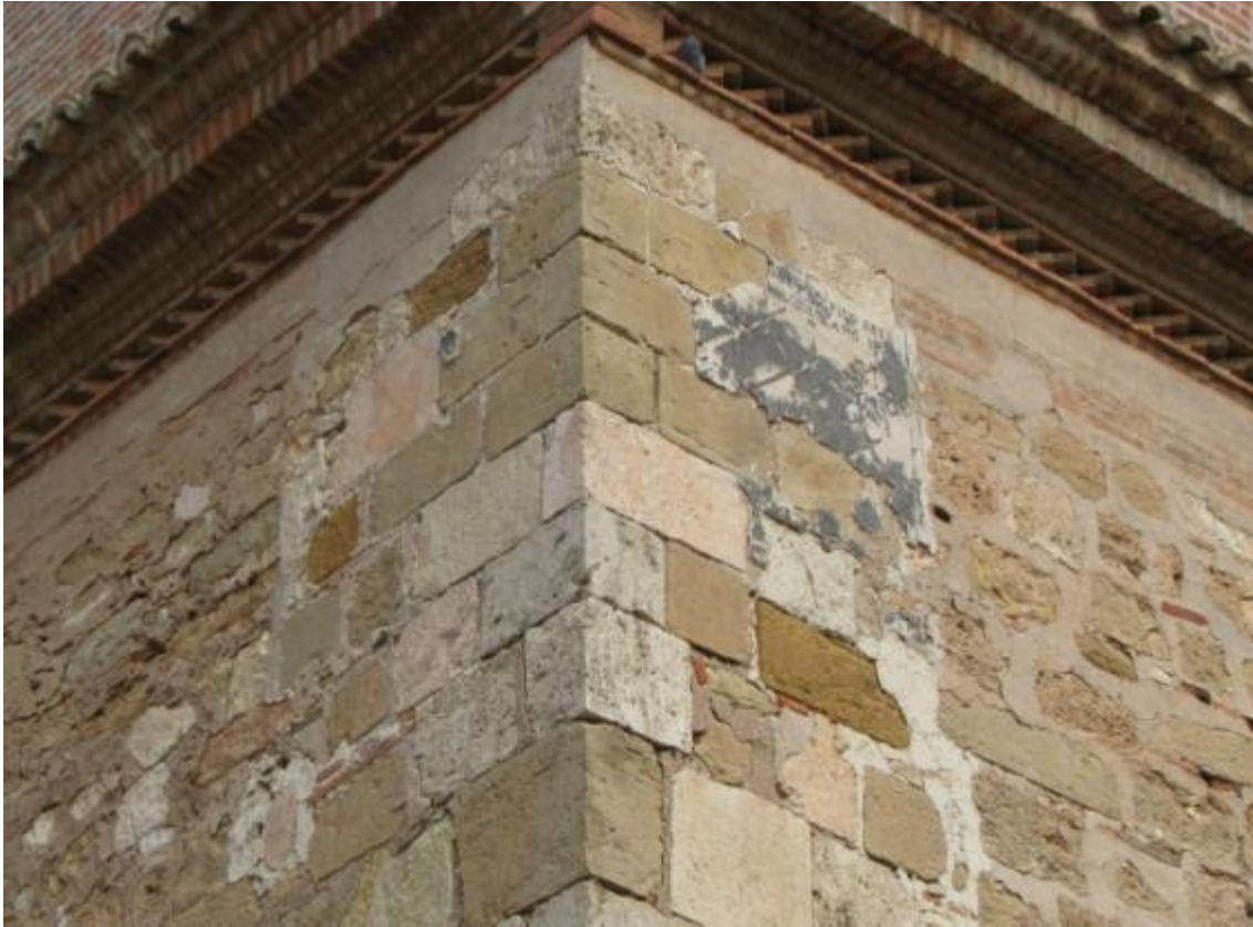
El reloj de sol doble fotografiado el año 2014. Continúa el deterioro.
