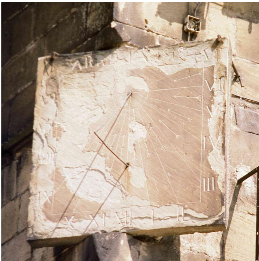
Estado del reloj de sol en el año 1987. guregipuzkoa.net/photo/1058395
