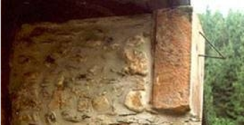
Varilla original acodada.
