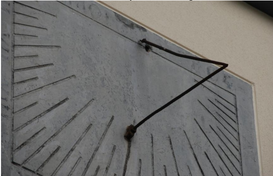
Varilla acodada desprendida del polo.
