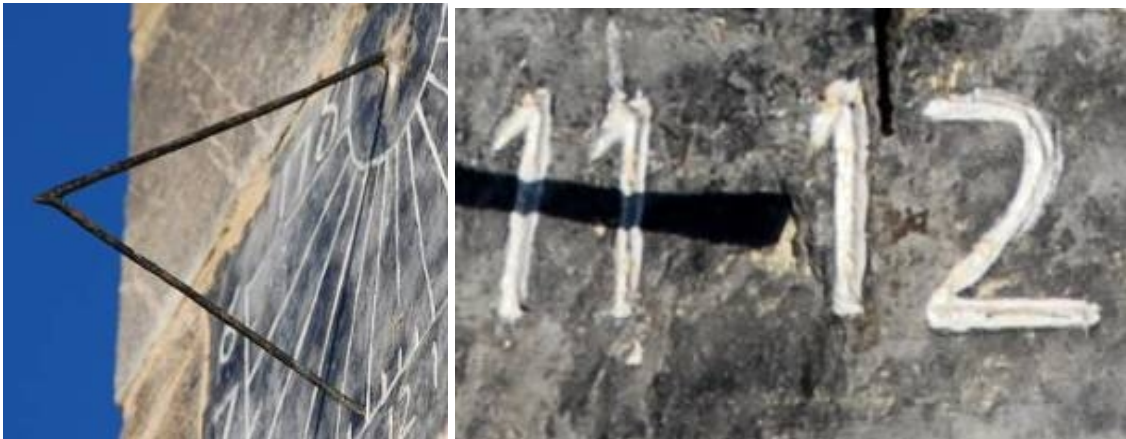
Varilla acodada. El tramo de apoyo se ha desprendido.
