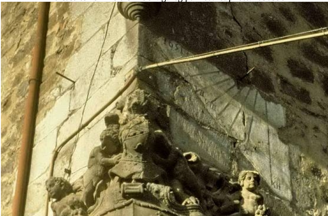
Estado del reloj de sol en el año 1987. guregipuzkoa.net/photo/1050591
