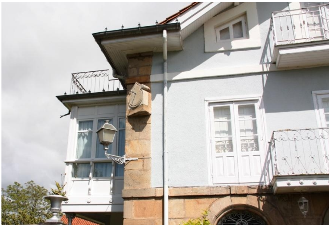
Situado en la esquina izquierda de la casa, demasiado cerca del alar del tejado.
