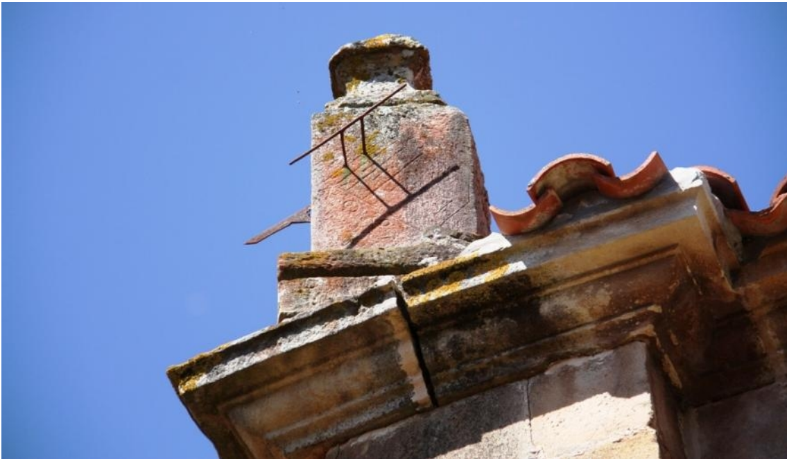
Apoyado sobre la cornisa del tejado, en la esquina sureste de la cabecera.
