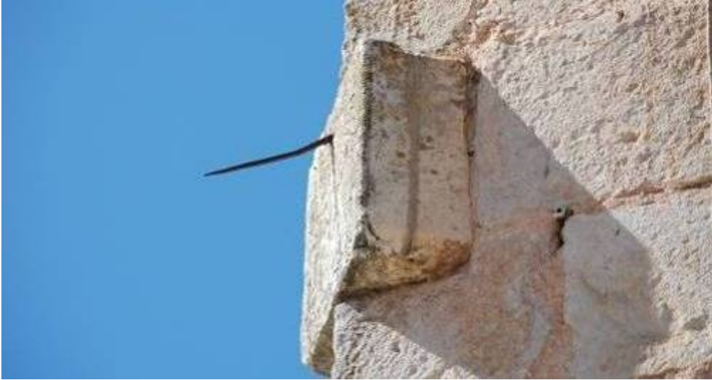
Varilla de perfil circular de un solo apoyo. Mal orientada.
