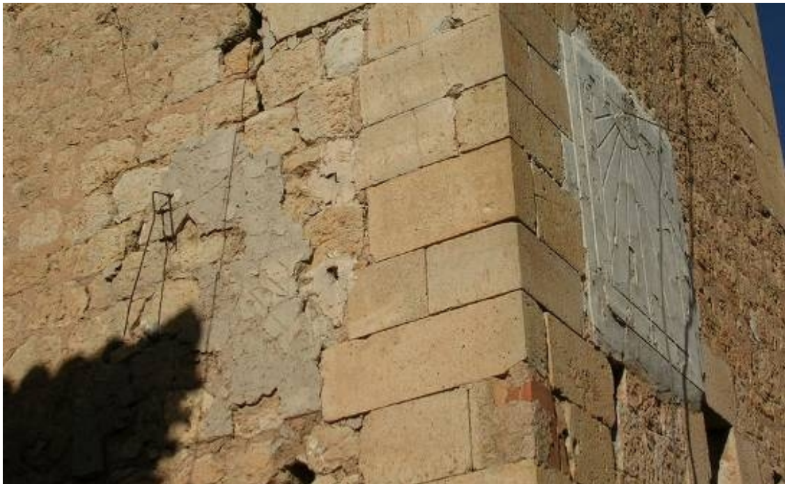
Esquina suroeste de la torre. El declinante a poniente se encuentra en muy mal estado.
