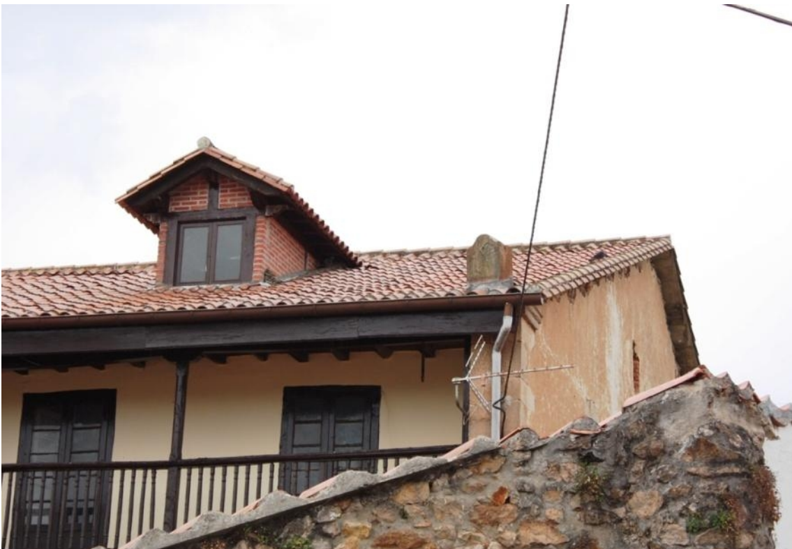
Situado sobre el tejado en la esquina sureste.
