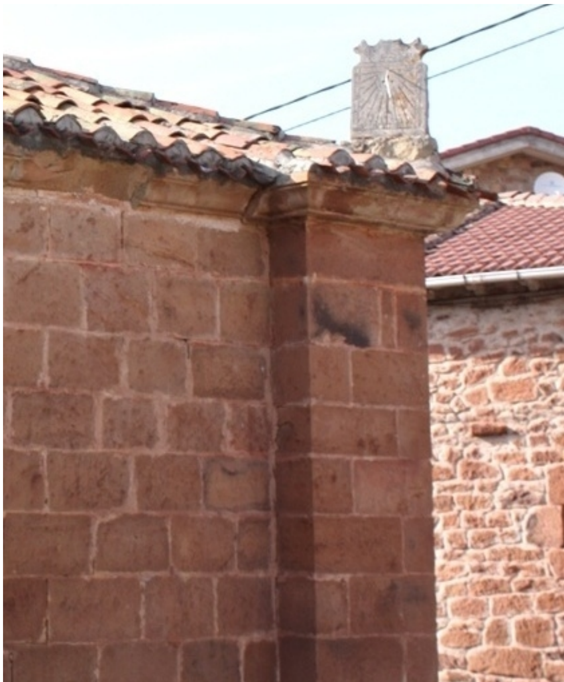
Placa de piedra exenta orientada sobre el tejado de la esquina NE de la cabecera.
