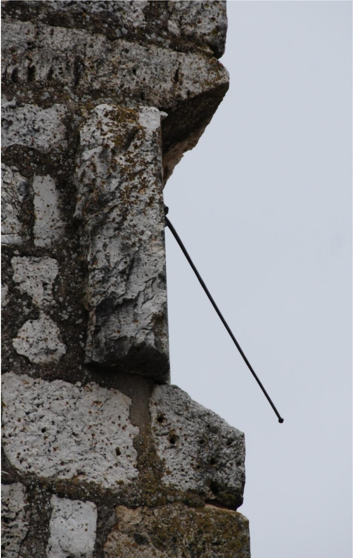
Varilla de un apoyo, mal orientada, terminada en una bolita.
