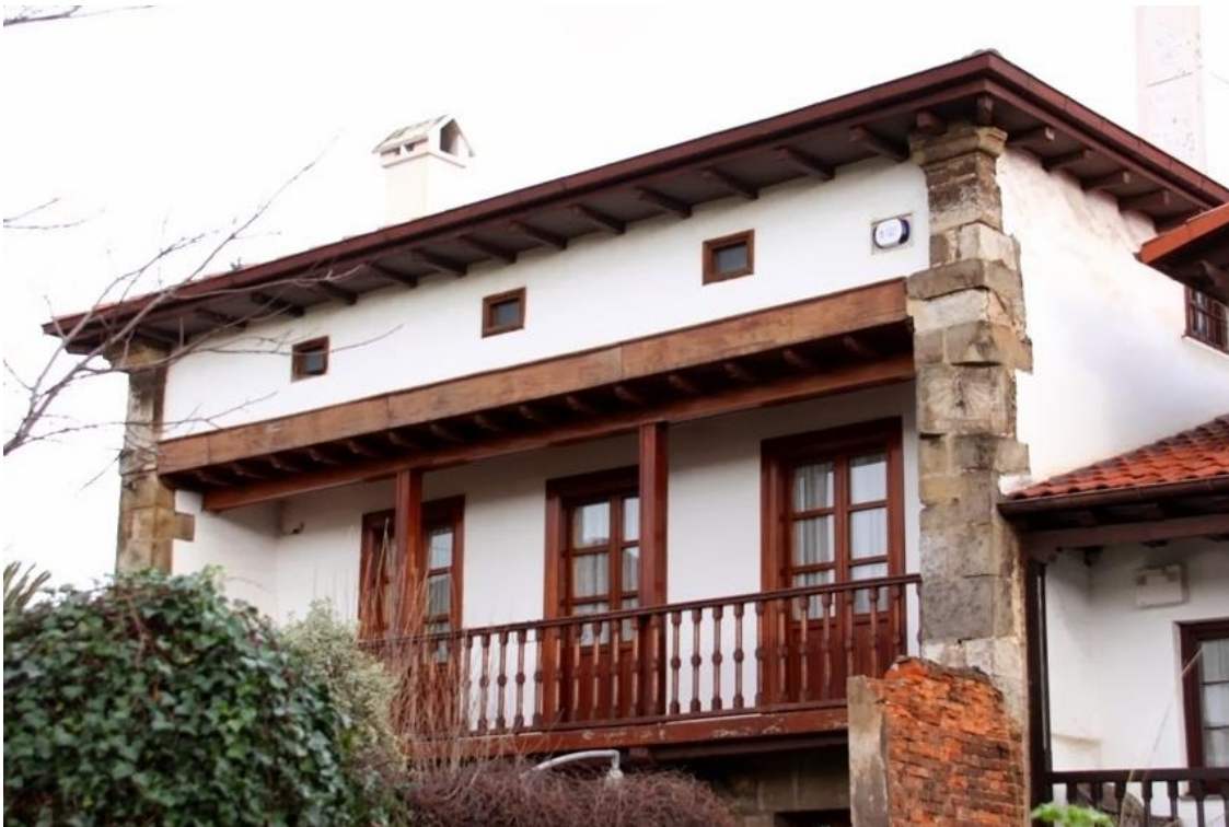
Sillar girado empotrado en el cortafuegos derecho.
