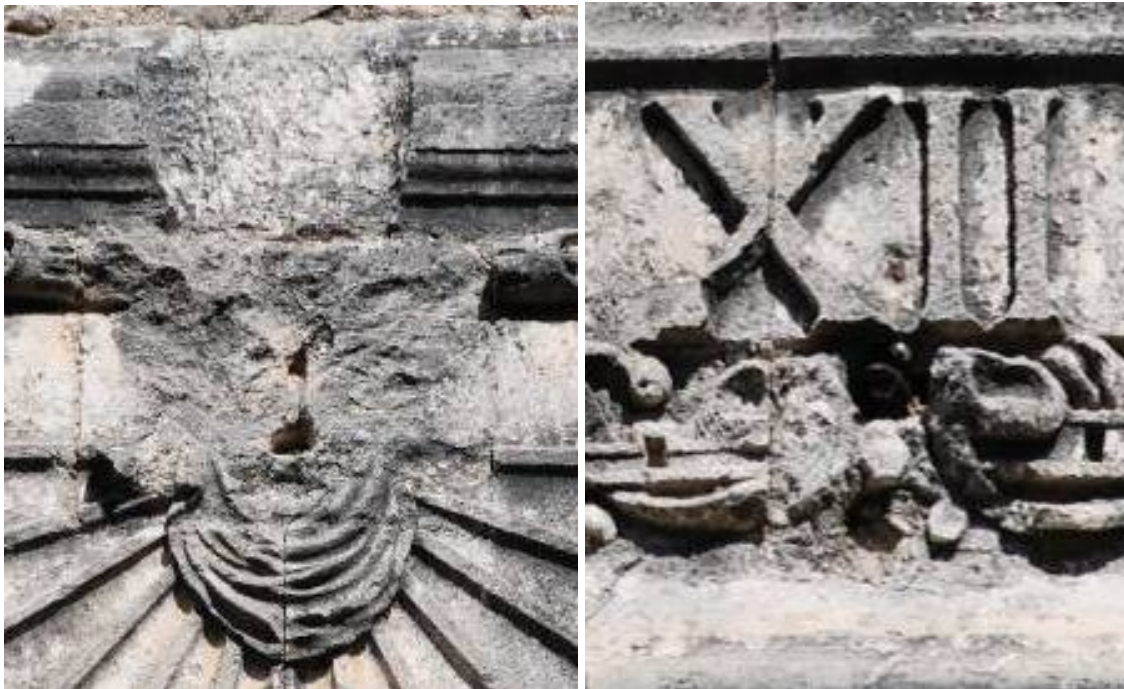
Varilla. Orificios. Desperfectos.
